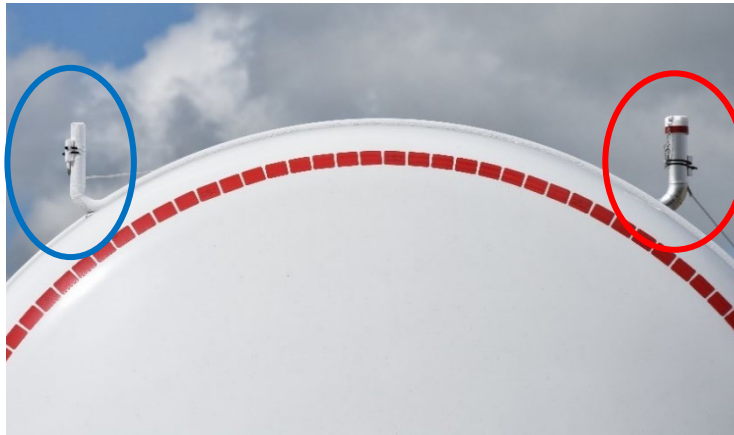
Abbildung 26: Blau: Vent-Line im vereisten Zustand durch vorhergehendes Venting inklusive Temperatursensor, Rot: Blow-Off-Line inklusive Temperatursensor und Abdeckklappe.
