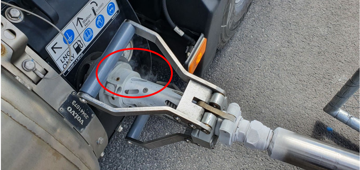
Abbildung 25: Tankstutzen mit leichten Methanemissionen bei der Kupplung ist auf dem Foto als weisse Kondensatwolke in der roten Ellipse erkennbar.
