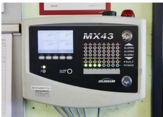
Des systèmes d'avertissement de gaz avertissent de la présence de concentrations de gaz explosives.
