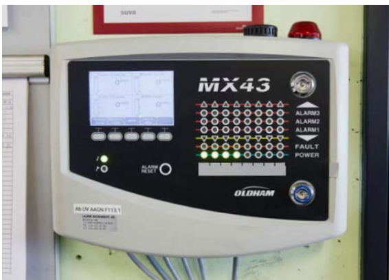
Gaswarnanlagen warnen vor explosionsfähigen Gaskonzentrationen.
