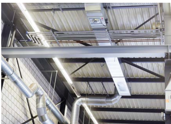
Mit künstlicher Lüftung kann eine ausreichende Lüftung sichergestellt werden.
