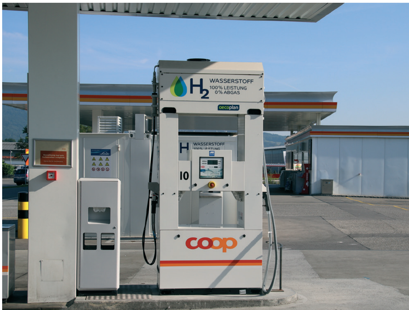
La première station-service à hydrogène publique de Suisse est opérationnelle depuis 2016 à Hunzenschwil (AG).
